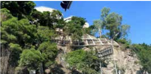
改造前山体岩石裸露，呈危岩体状态，且植被稀少
